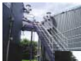
Digesteur principal à gauche.
